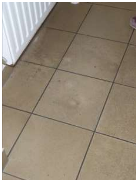
Csapadékvíz összefolyónál lévő beázás.
