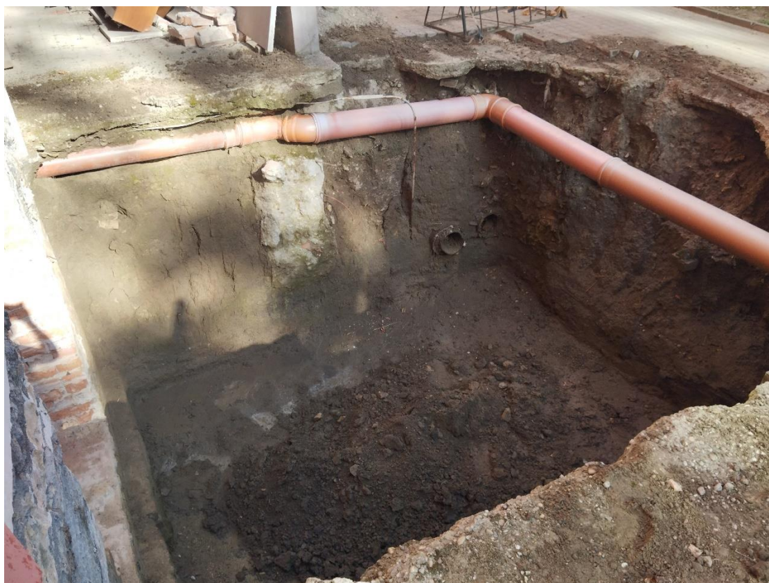
Közművek és betonelemek a liftakna oldalfalában
