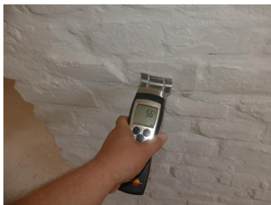
Szigeteléssel ellátott, új földemet támasztó, kitöltő falazat nedvességtartalma a szigetelés síkja felett 5,6 m% felett a kerékpártárolóban
