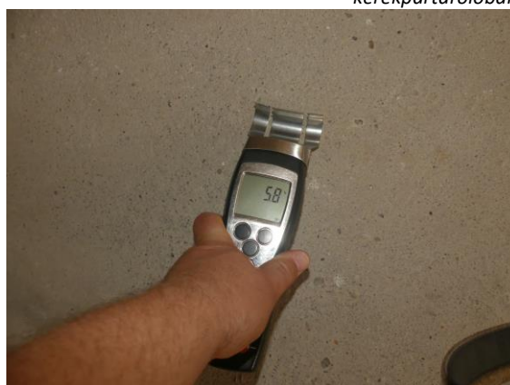
Szigeteetlen pincepadló nedvességtartalma 5,8 m%
