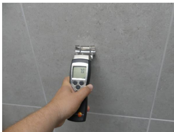
Belső fal nedvességtartalma 7,8 m% felett a kukatárolóban
