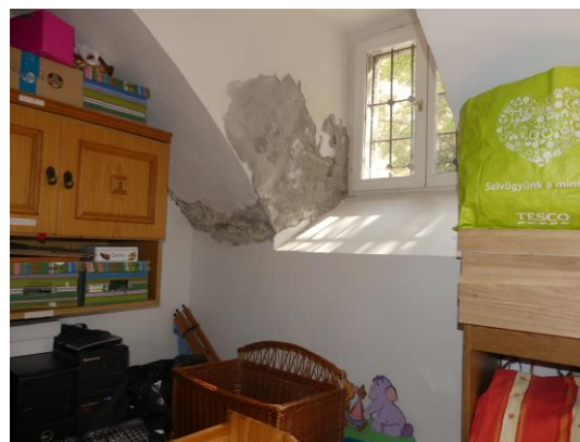
Vakolatkár a főbejárat melletti belső pincefödémén
